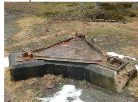
Fundament för fyrmast i Vallentuna, vid norra änden av Jarlavägen i Ormsta, BoJu.
