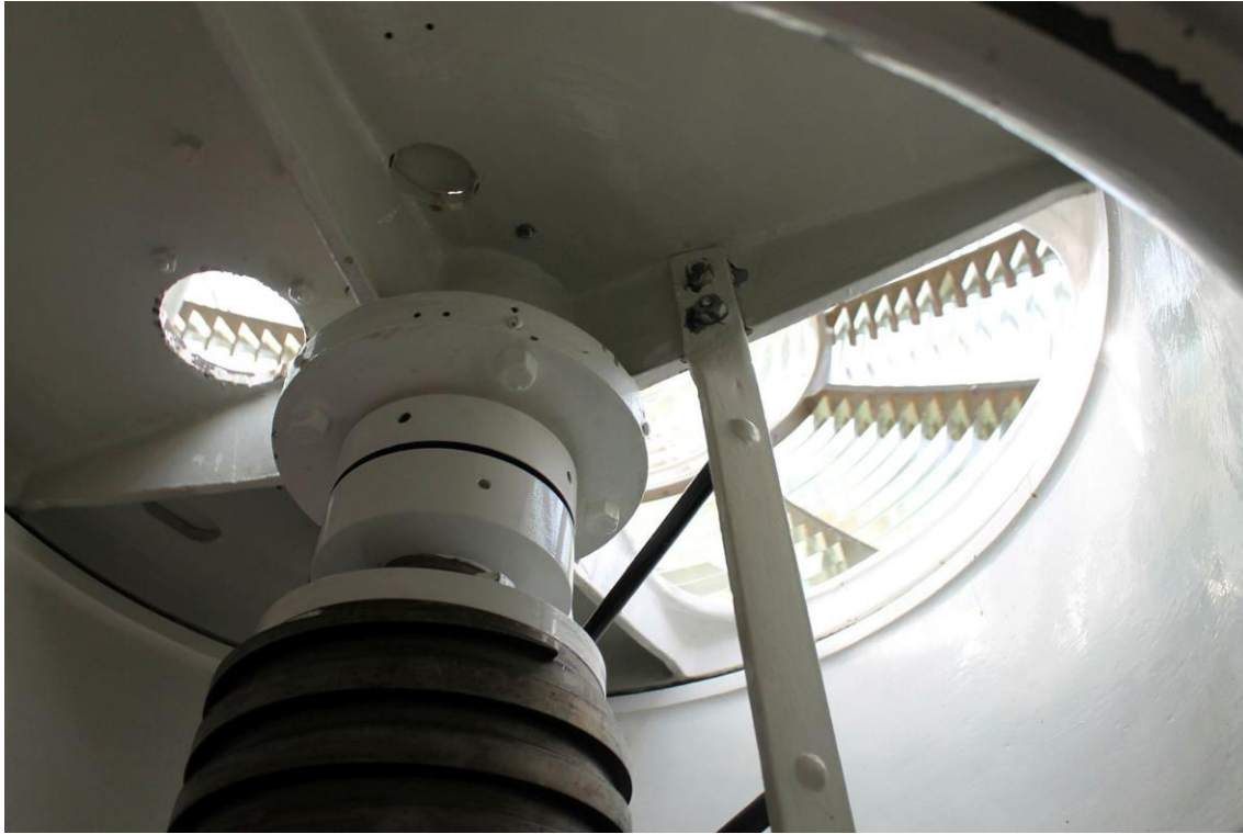
I veckan kom en ingenjör och satte dit kullager under linskonstruktionen på fyren. Bild: Astrid Adelgren
